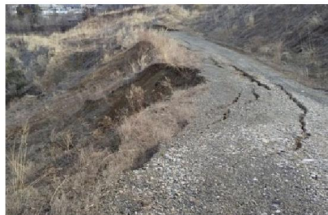
盛土法肩の大規模な亀裂・崩壊
