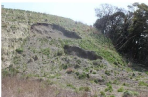
盛土法面の部分的な崩壊
