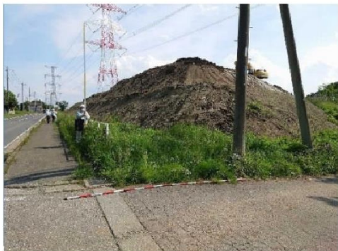
標識の掲示のない無許可盛土
